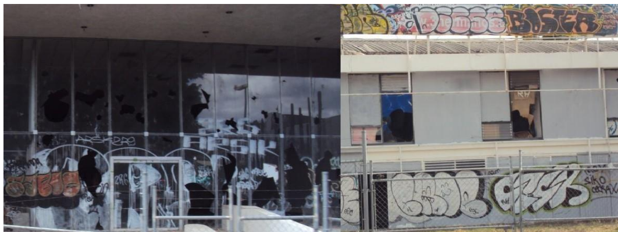
Figura 2. Ejemplos de Edificios en deterioro (ventanas rotas) sobre el Boulevard Adolfo López Mateos en la ciudad de León, Guanajuato. (Fotografías por autores).
